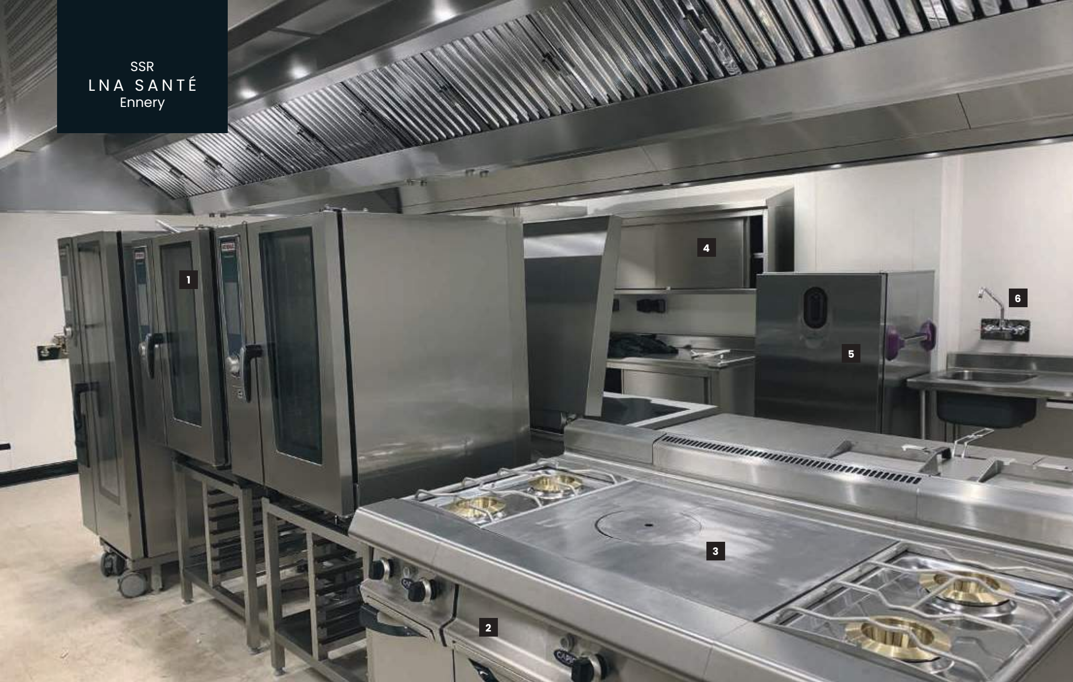
1 Four mixte RATIONAL (x3) 2 Fourneau gaz CAPIC 3 Fourneau 4 feux vifs + plaque coup de feu CAPIC 4 Inox BENARD INOX 5 Armoire de maintien en température BOURGEAT 6 Robinetterie murale MADIAL
