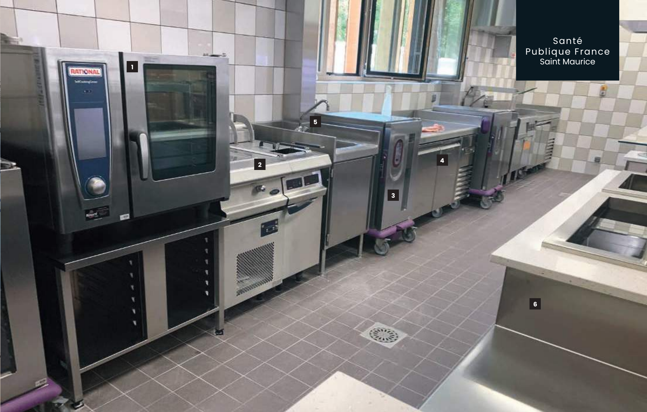
1 Four mixte RATIONAL 2 Cuiseur à pâtes avec refroidisseur CAPIC 3 Armoire de maintien en température BOURGEAT (x2) 4 Meuble réfrigéré ASBER (x2) 5 Plonge sur mesure BENARD INOX 6 Self sur mesure
