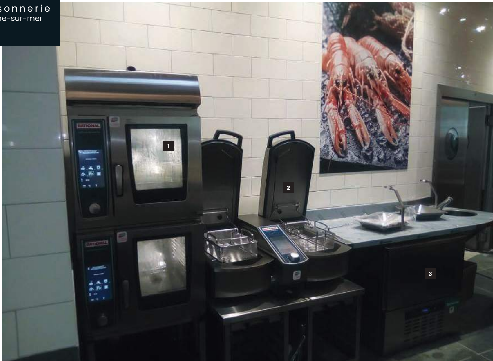
1 Four mixte RATIONAL avec hotte Ultravent (x2) 2 VCC 112 RATIONAL + support 3 Cellule de refroidissement TECNOMAC
