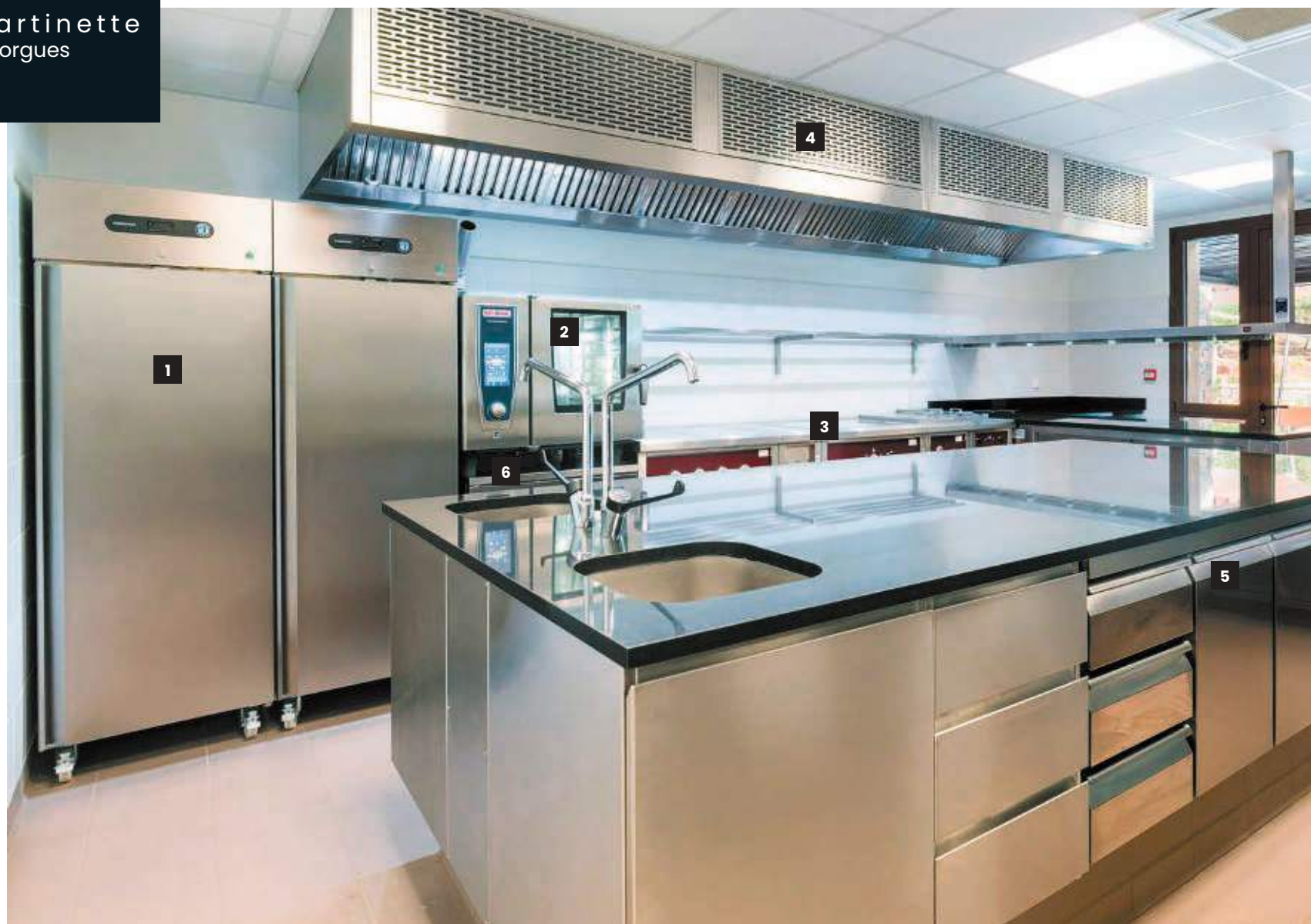
1 Armoires HOSHIZAKI 2 Four RATIONAL 3 Fourneau CHARVET 4 Hotte SAFTAIR 5 Meuble froid HOSHIZAKI 6 Cellule de refroidissement CASTEL MAC
