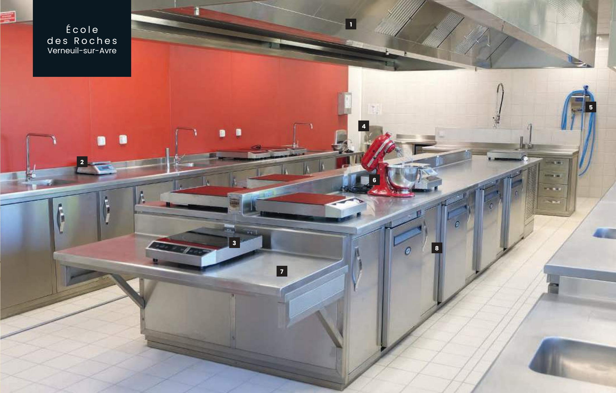
1 Plafond filtrant SAFTAIR 2 Balance CREATIVE BALANCE 3 Induction posable TECNOX 4 Lave-mains TOURNUS 5 Poste de désinfection ERDEMIL 6 Batteur KITCHENAID 7 Meuble sur mesure ARTINOX 8 Meuble réfrigéré FOSTER
